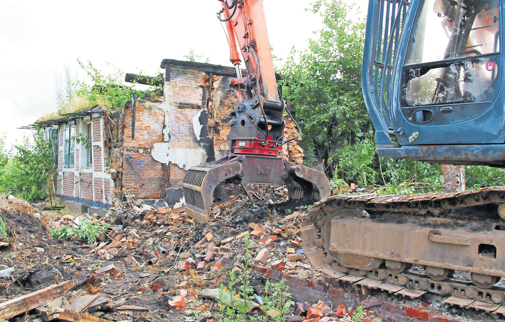
Auf dem Gelände der ehemaligen Traditionsraststätte „Herbstprinz“ arbeiten sich die Bagger durch die verkohlten Überreste des Gebäudes.
